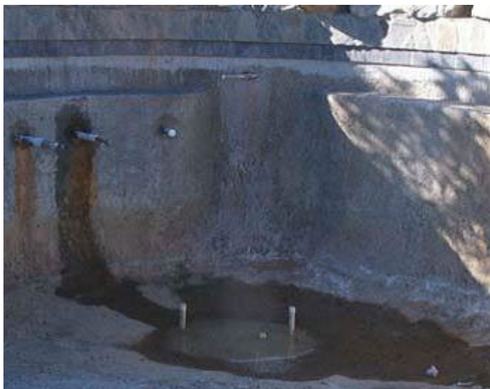
Intrusión de agua en las penetraciones desde detrás de la estructura antes de la aplicación del revestimiento de acabado interior
